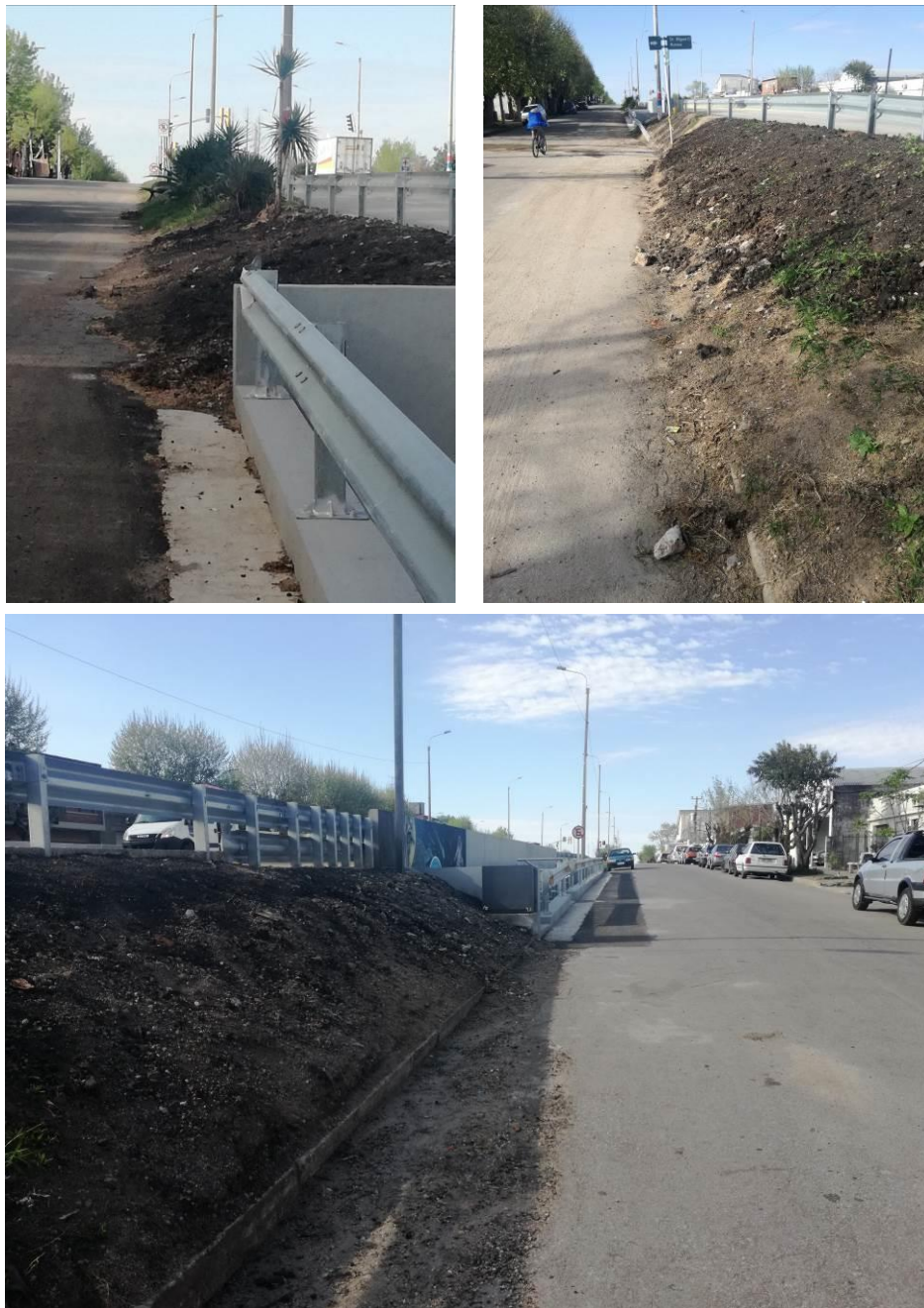
Foto 13.1-1 Falta de recubrimiento vegetal
