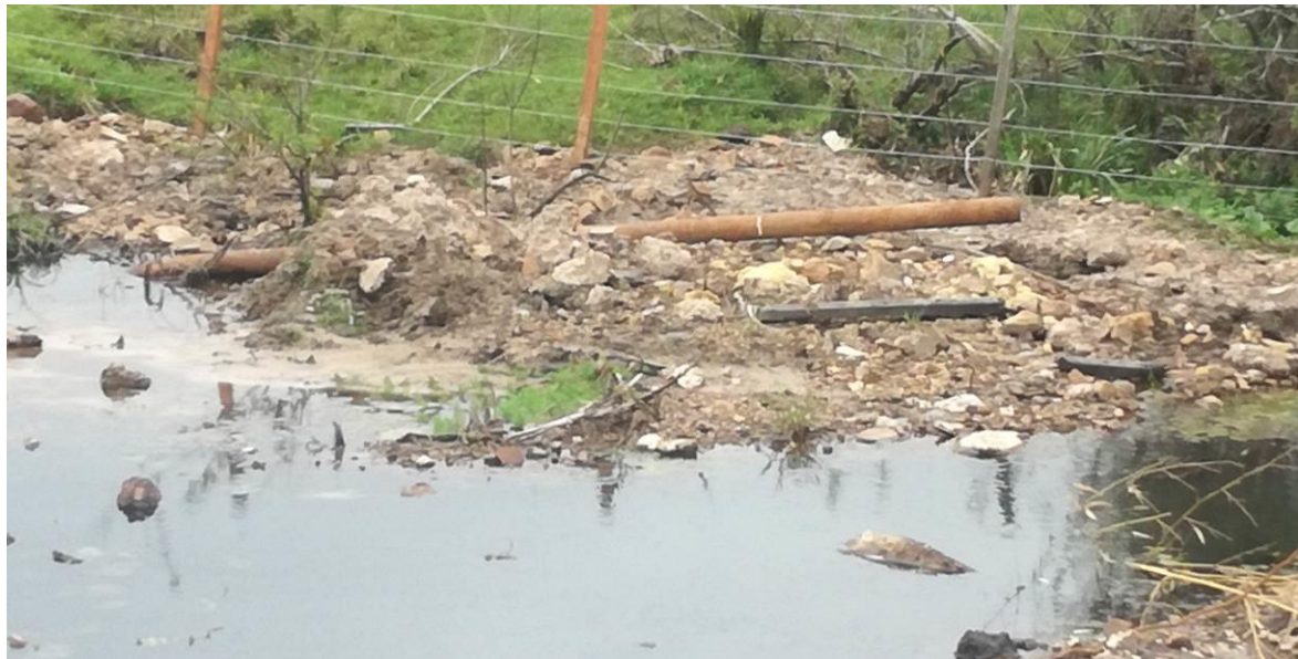
Foto 13.2-1 Restos de material próximo al cauce_ prog. 212km110.
