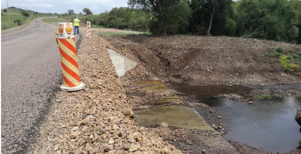
Foto 13.2-3 Restos de material en cauce_ prog. 190km800.
