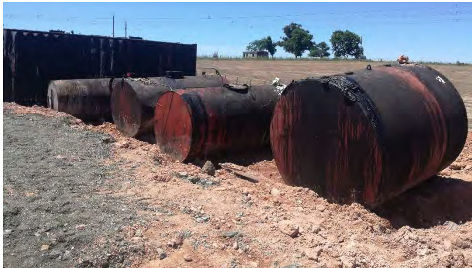
Foto 13.3-1 Tanques de asfalto sin dique de contención – Obrador CUJÓ
