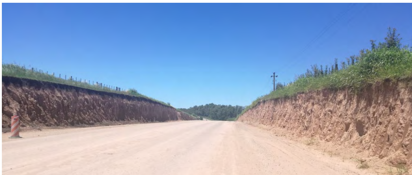
Foto 13.1-1 Vta.6 Terraplenes con riesgo de erosión
