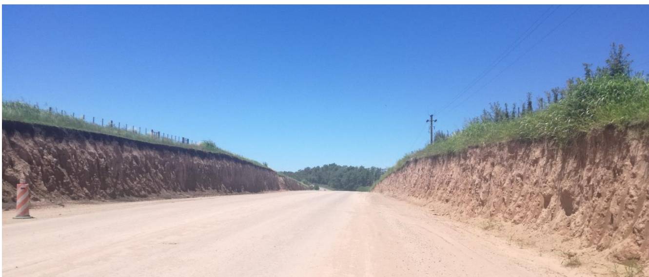
Foto 13.1-1 Vta.6 Terraplenes con riesgo de erosión
