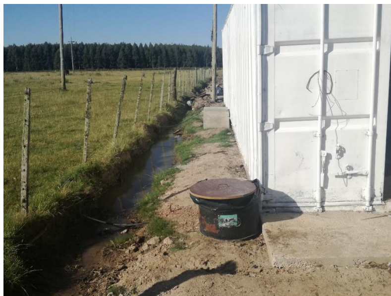
Foto 13.10-1 NC 8 Desagüe de pileta al terreno en Obrador ESPINA
