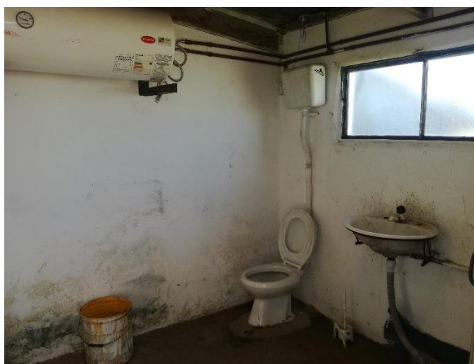
Foto 13.7-1 NC 5 - Baño sin estructura necesaria para mantener la higiene requerida en Obrador Díaz Álvarez
