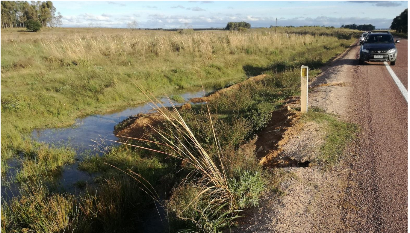
Foto 13.2-1 Vista.3 – Ruta 7 Agua estancada en alcantarilla
