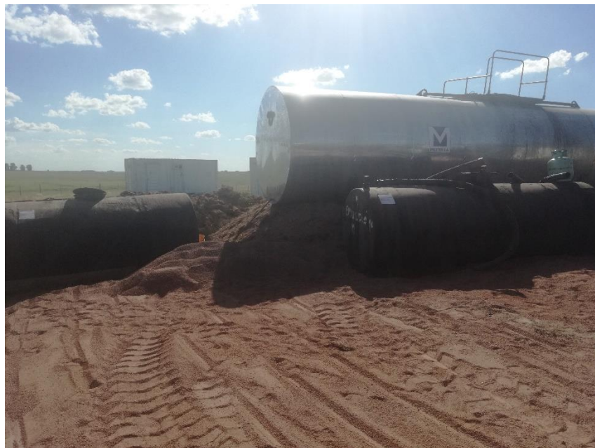
Fotos 13.3-1 Tanques de asfalto con dique de contención inadecuado
