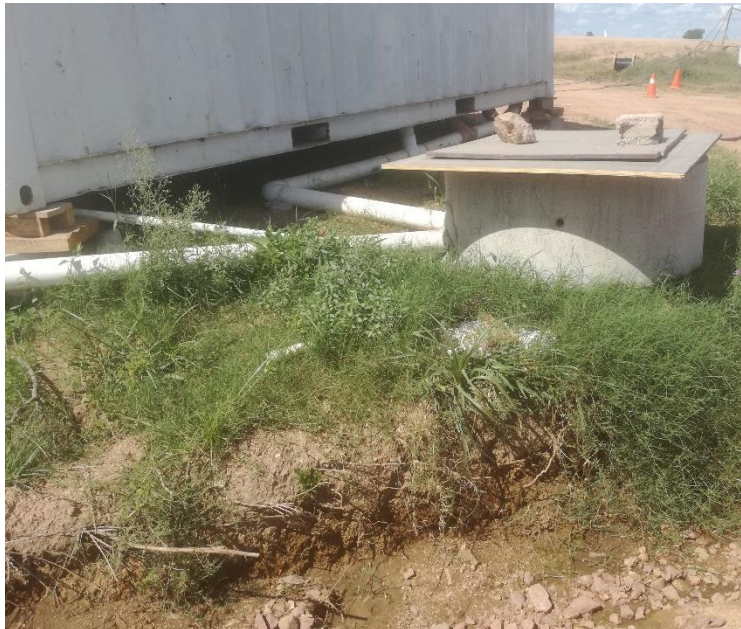
Foto 13.2-1 Fosa séptica con pérdida.
