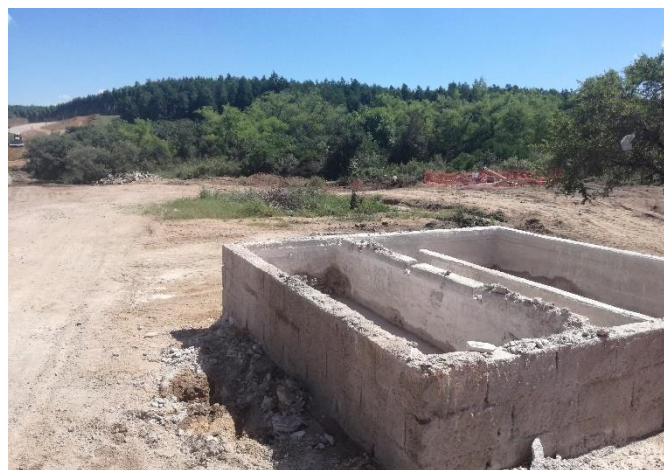
Fotos 13.1-2 Pileta de lavado de hormigón en zona inundable.
