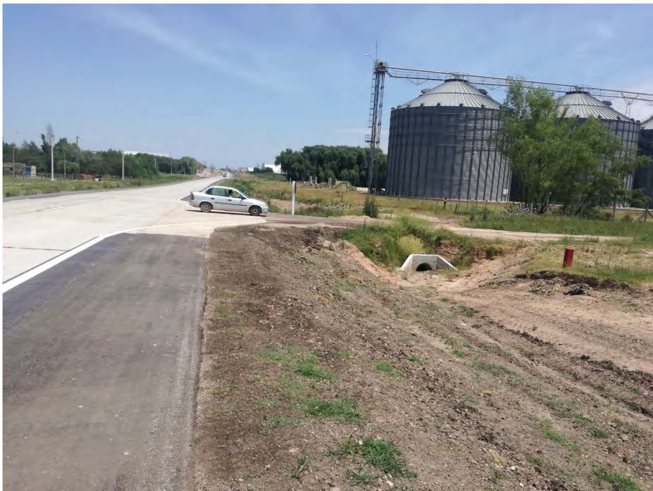
Foto 13.2-1 Vta.3 Alcantarilla obstruida
