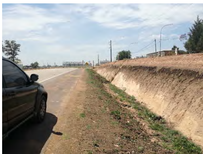
Foto 13.9-3 Vta.1 - Taludes con riesgo de erosión
