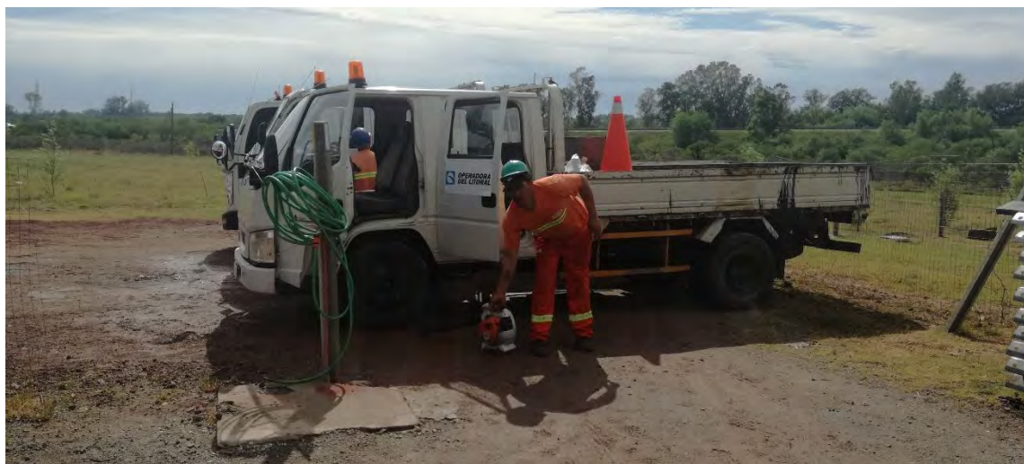
Foto 13.16-2 Equipo cuadrillas de mantenimiento
