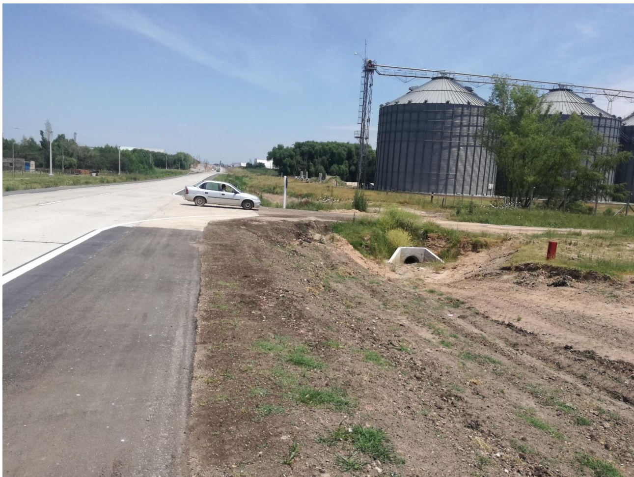
Foto 13.2-1 Vta.3 Alcantarilla obstruida
