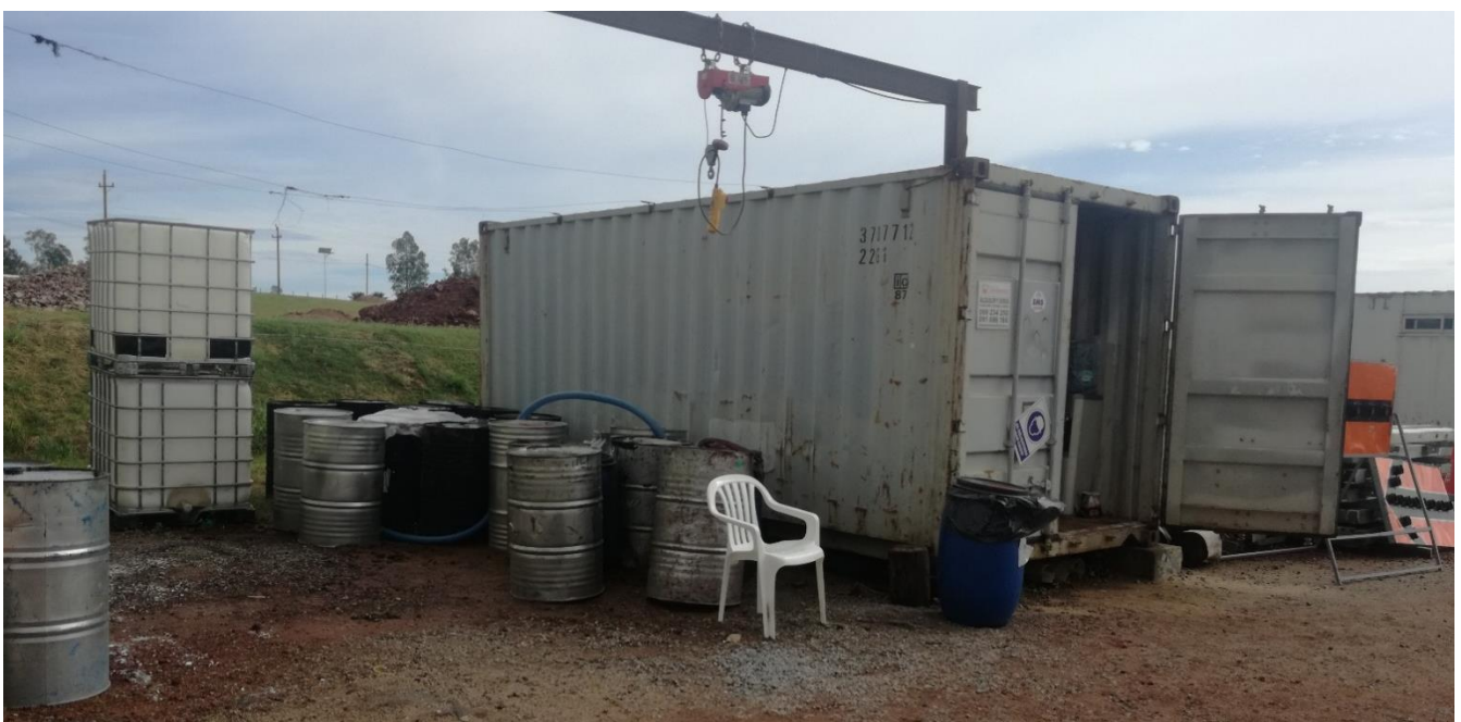
Foto 13.5-1 Tanques con hidrocarburos sin dique de contención en Obrador Operadora del Litoral
