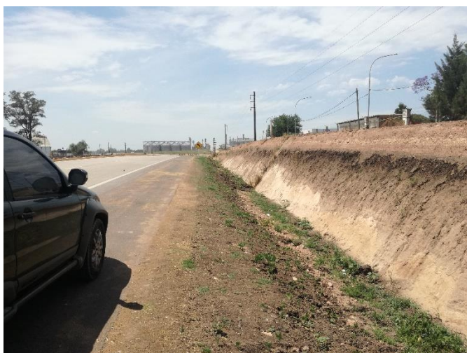
Foto 13.9-3 Vta.1 - Taludes con riesgo de erosión
