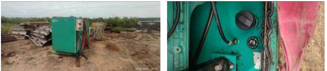
Foto 12.2-1 Generador sin dique de contención.
