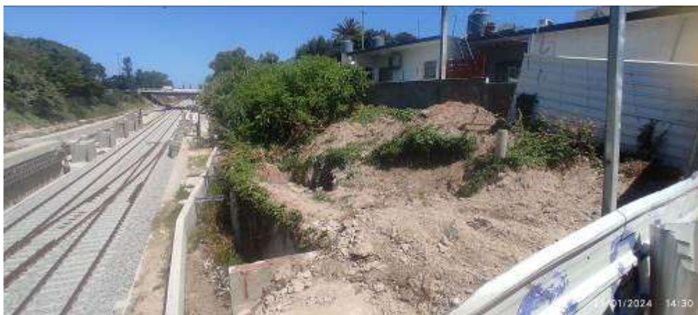
Foto 12.2-1 Talud sin conformar.
