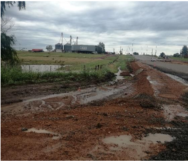
Foto 1 Observación Material acumulado próximo al canal de la alcantarilla.
