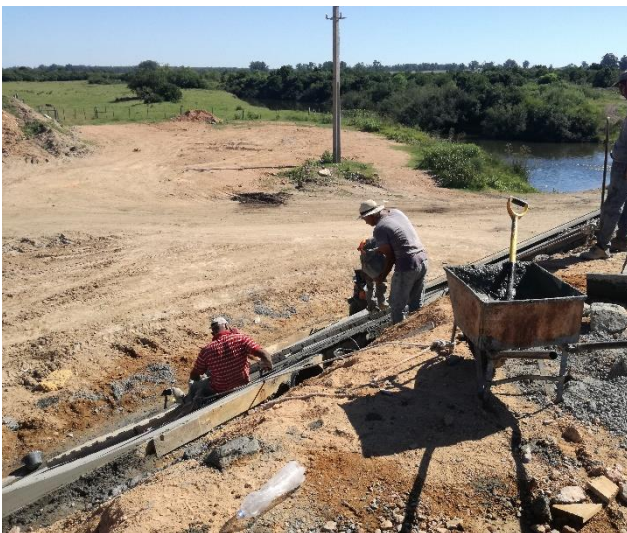
Foto 7 No Conformidad. Personal trabajando sin protección.
