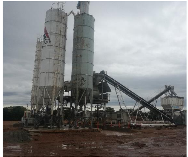
Foto 2 Vista planta de hormigón
