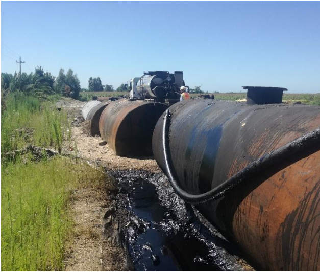
Foto 5 No Conformidad. Tanques de asfalto sin contención y derrames.
