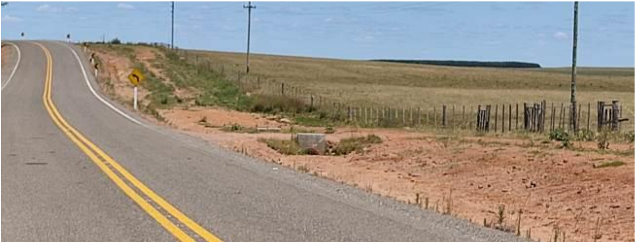
Foto 13.1-1 Vista 1 - Alcantarilla obstruida
