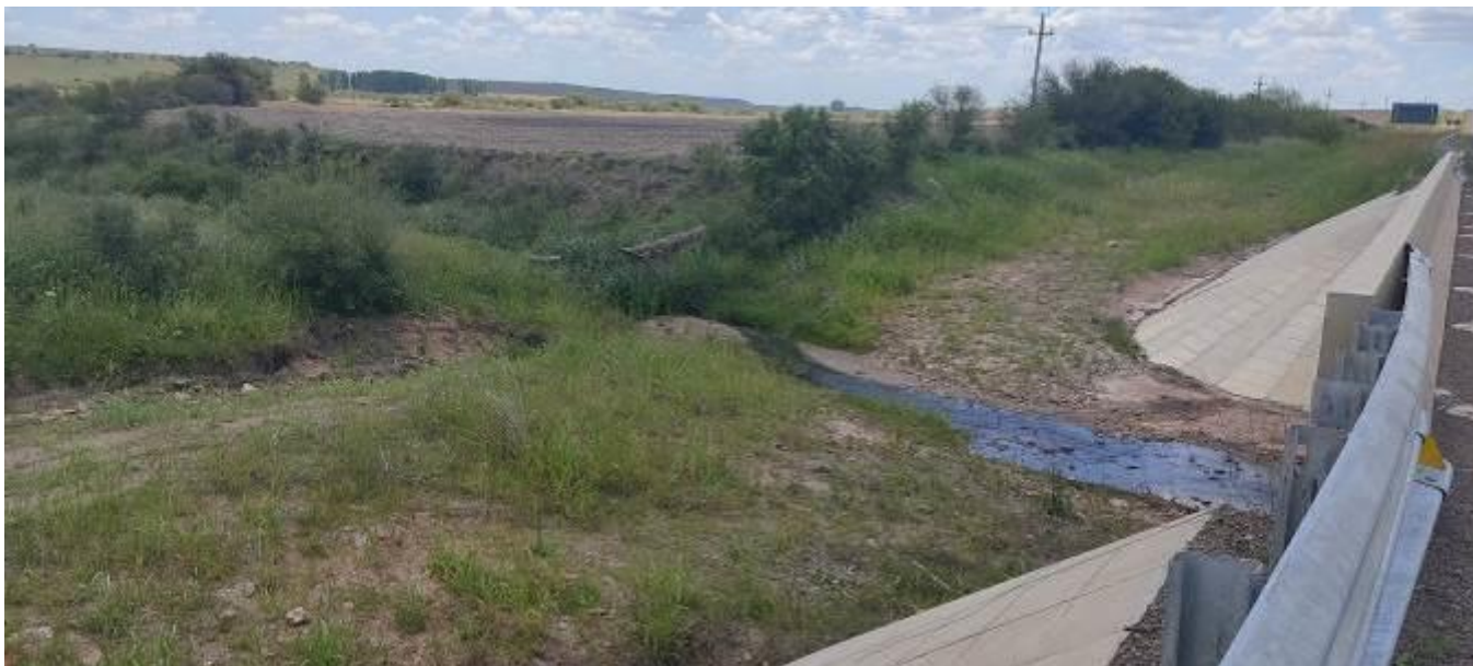
Foto 13.2-1 Vta.1 - Erosión en zona NW Pte. Caraguatá
