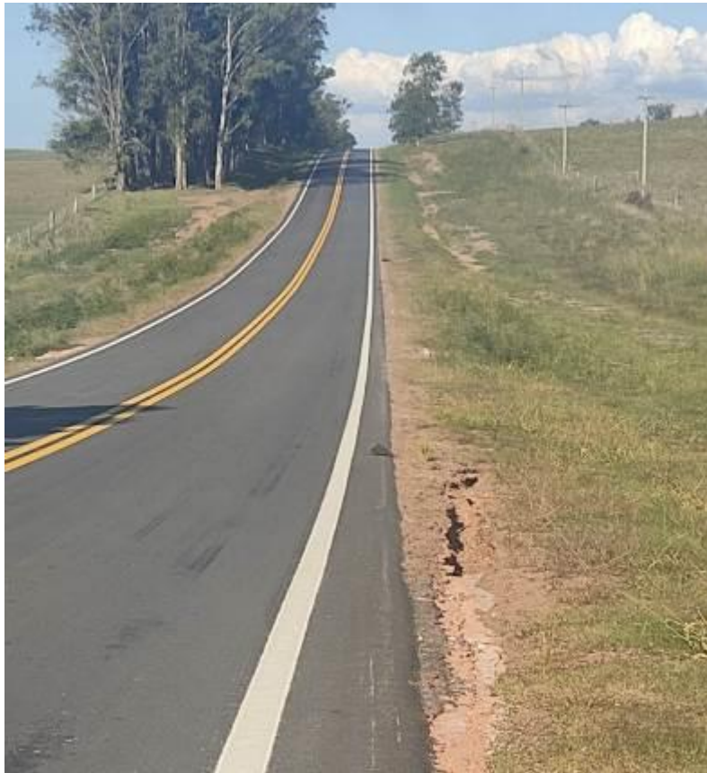
Foto 13.1-1 Vista 1. Erosión en banquina.
