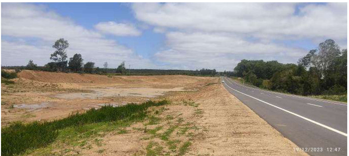
Foto 12.1-2 Faja con recuperación ambiental inadecuada.
