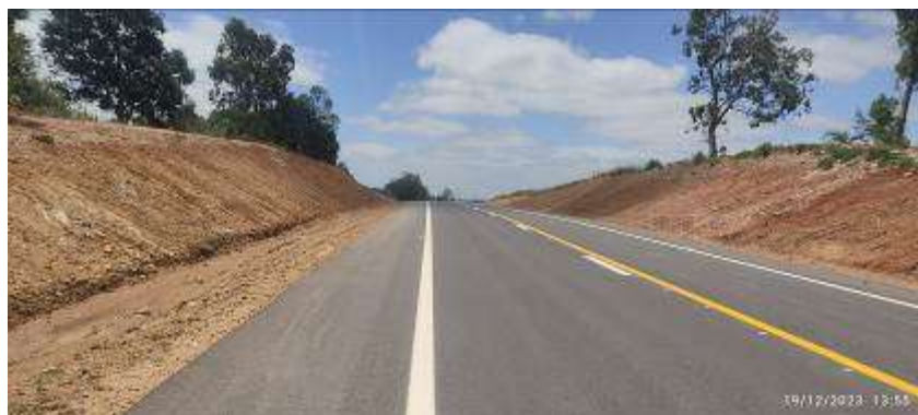
Foto 12.2-3 Erosiones en Ruta 15.
