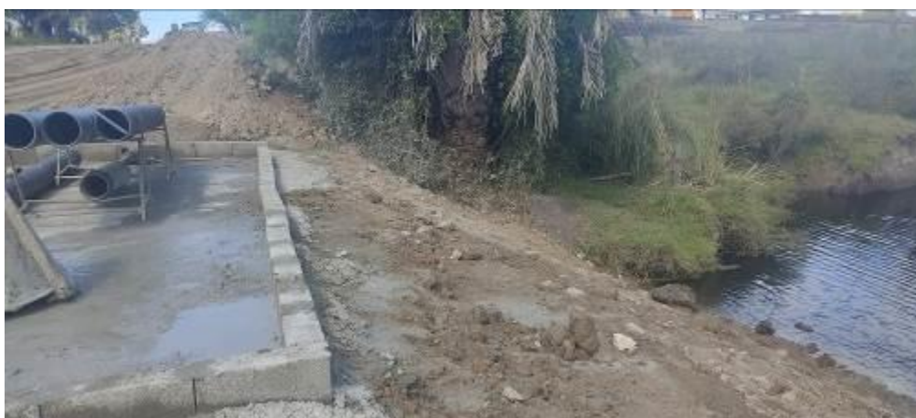
Foto 13.3-1 Derrame de hormigón
