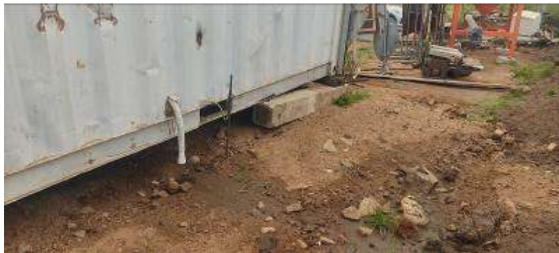
Foto 13.2-1 Desagüe de pileta directamente sobre la superficie del suelo.
