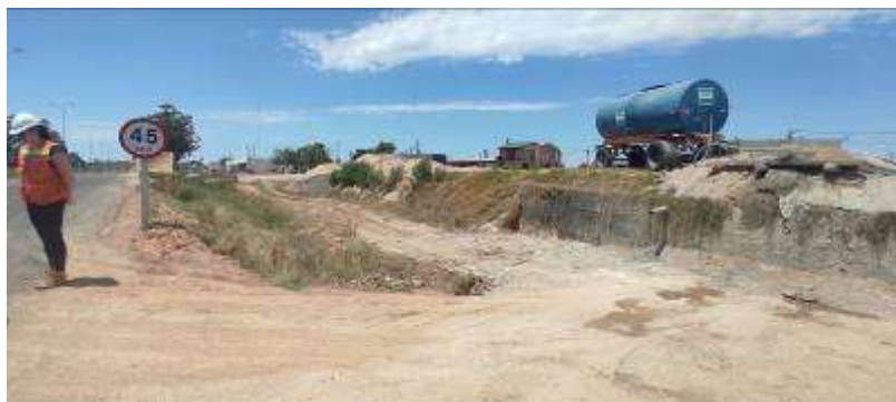
Foto 13.3-1 Derrames de lavado de hormigón.
