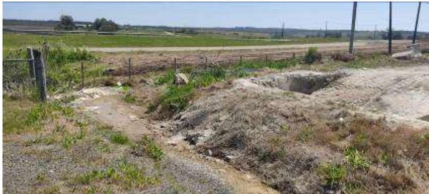
Foto 13.1-1 Derrame en Pileta de Lavado de Hormigón
