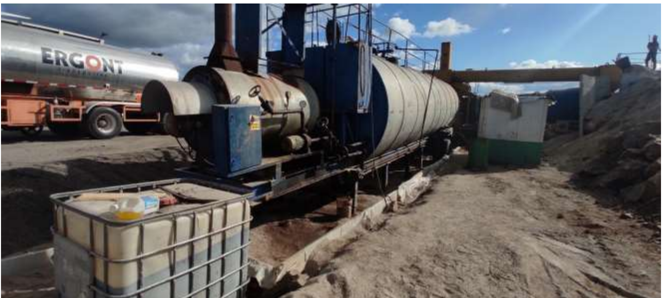
Foto 13.2-1 Pérdida de aceite en Bomba de Planta de Asfalto.
