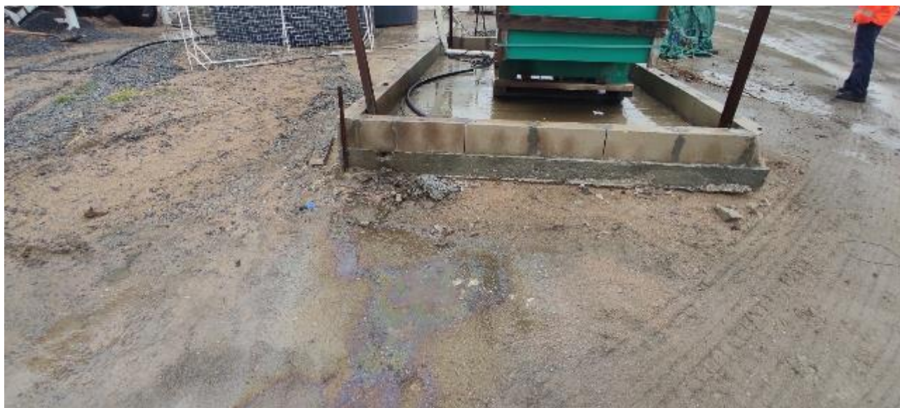
Foto 13.1-1 Dique para generador perforado y evidencias de derrame de hidrocarburos.
