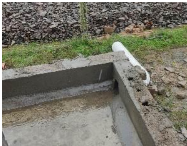
Foto 12.2-1 Caño de desagote de dique sin tapa.
