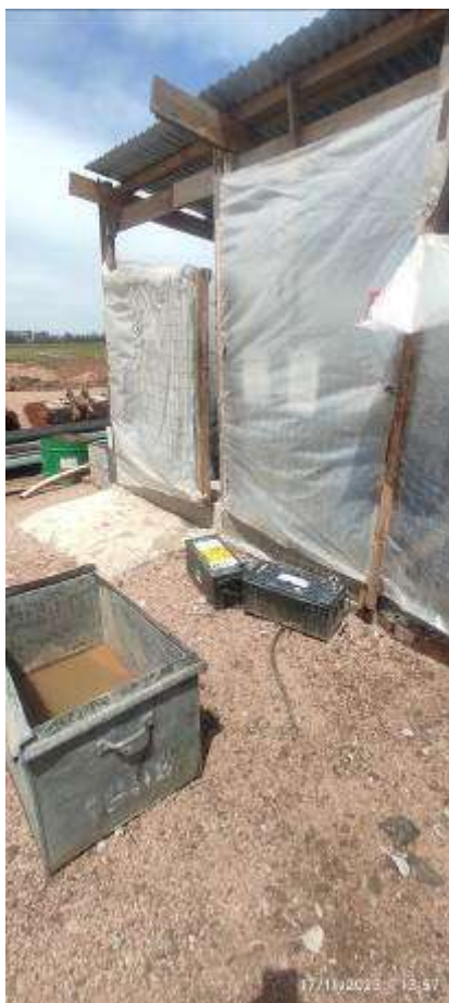
Foto 12.6-1 Baterías sin dique de contención.
