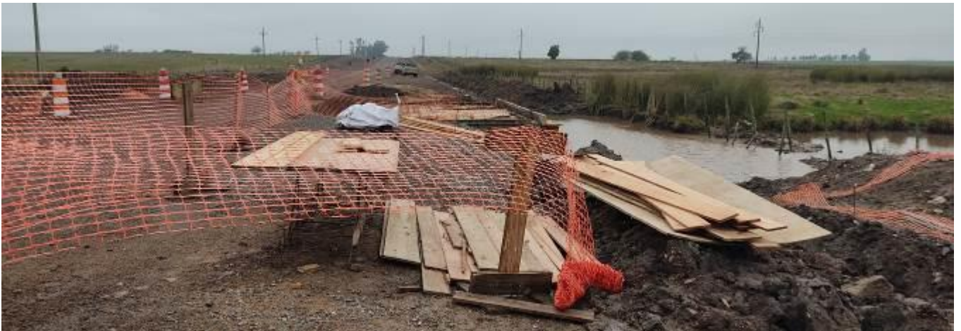
Foto 13.1-1 Materiales en zona inundable.
