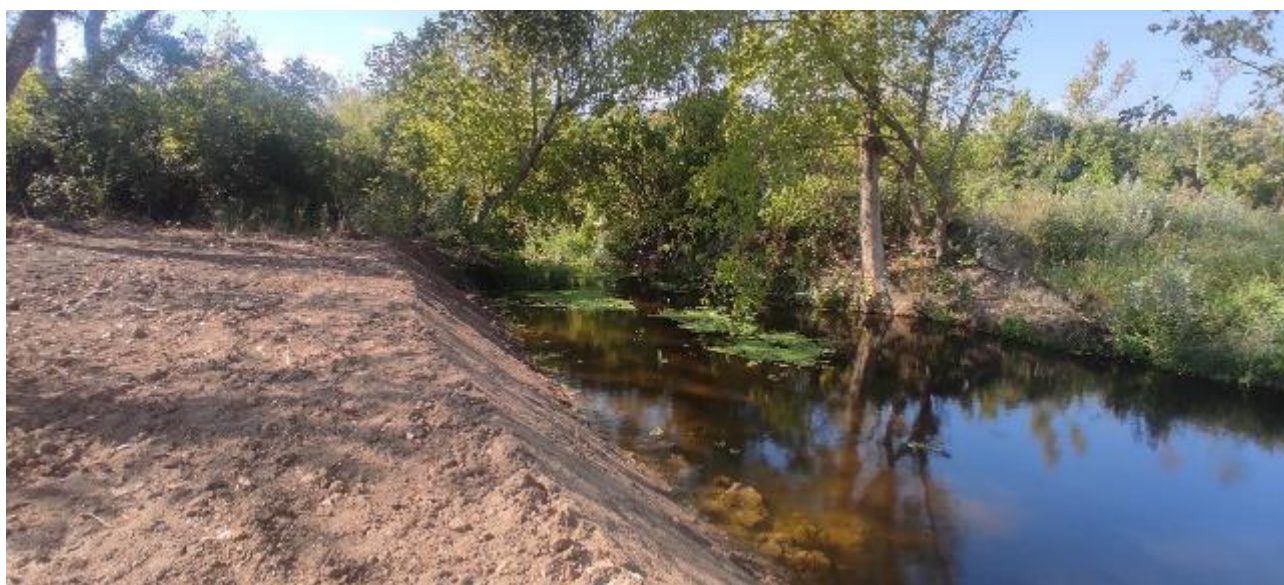
Foto 13.1-1 Riesgo de erosión.
