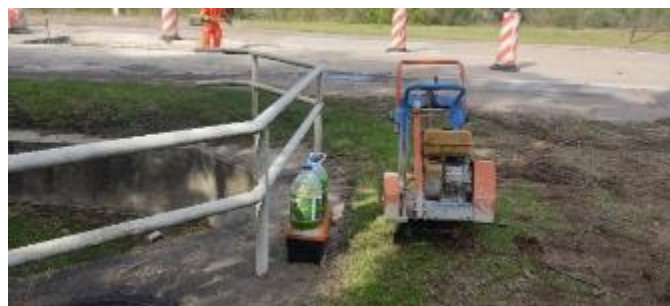
Foto 13.3-1 Envase de producto químico sin contención.
