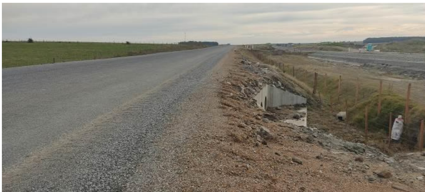
Figura 13.1-1 Vista 1 - Restos de materiales entorno a alcantarilla.
