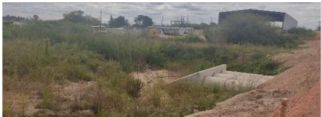
Foto 13.1-1 Alcantarilla tapada y erosiones en predio obrador FERRALIA
