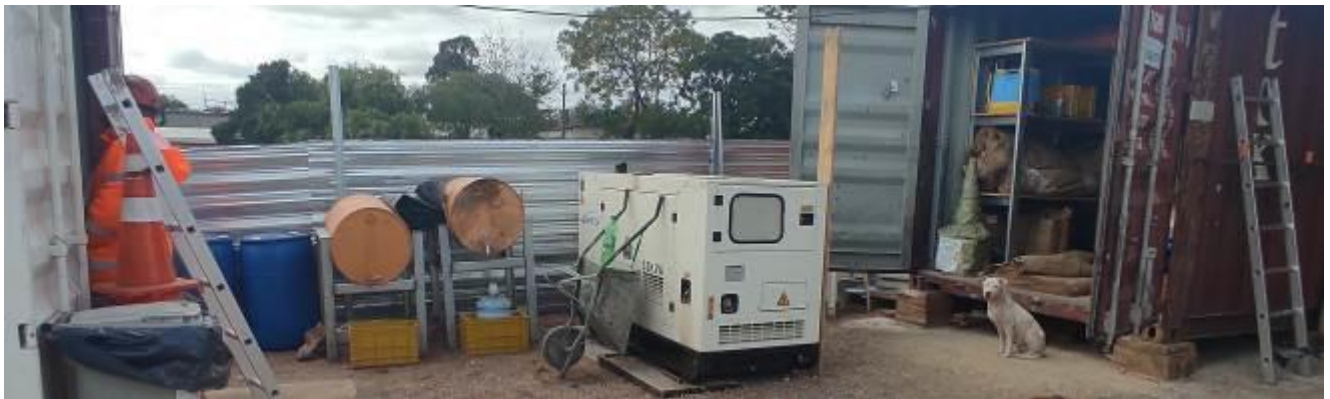
Foto 13.1-1 Tanques con productos químicos y generador sin diques adecuados.
