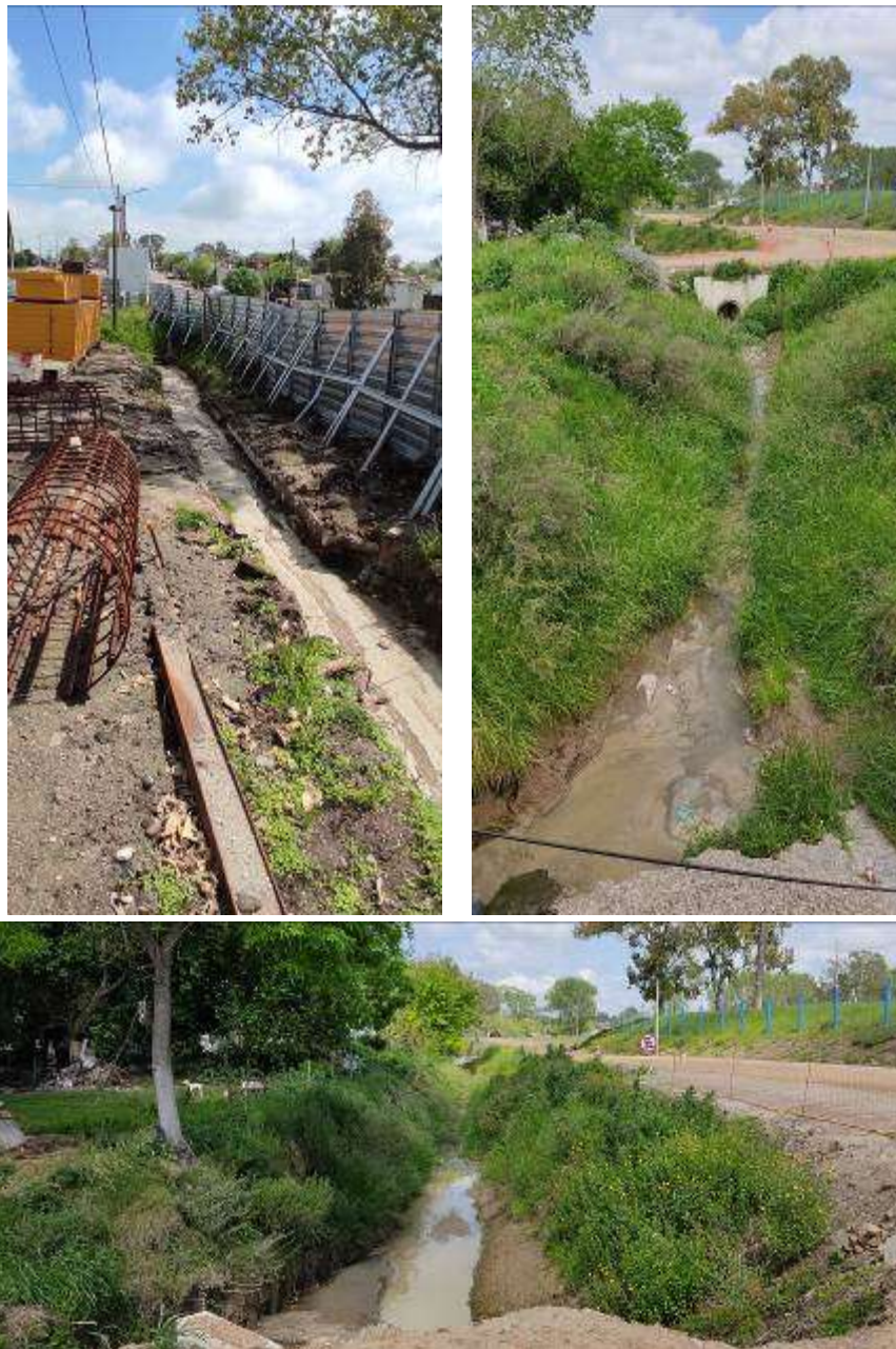
Foto 13.1-1 Derrames agua contaminada.
