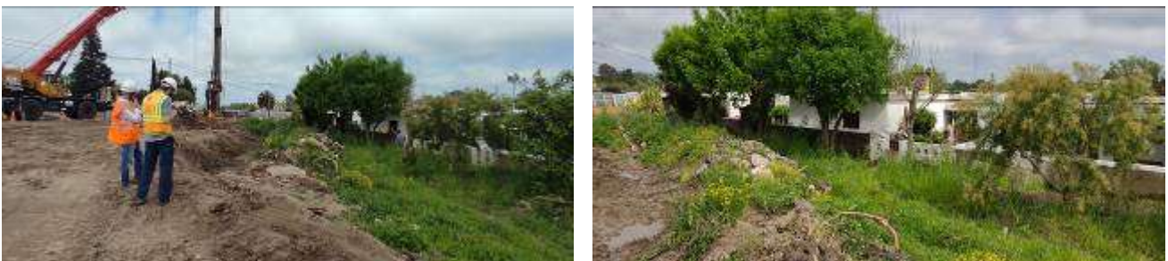
Foto 13.3-1 Falta de vallado en el entorno de obra.
