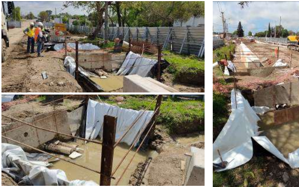
Foto 13.2-1 Pileta de decantación en mal estado.
