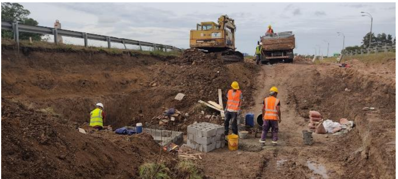
Foto 13.1-1 No se dispone una estructura para contener el agua del lavado de hormigón.
