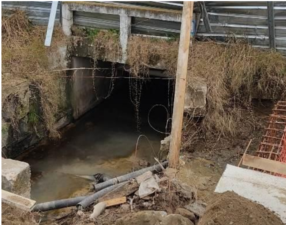
Foto 13.4-2 Restos de caños y cableado de servicios en alcantarilla.
