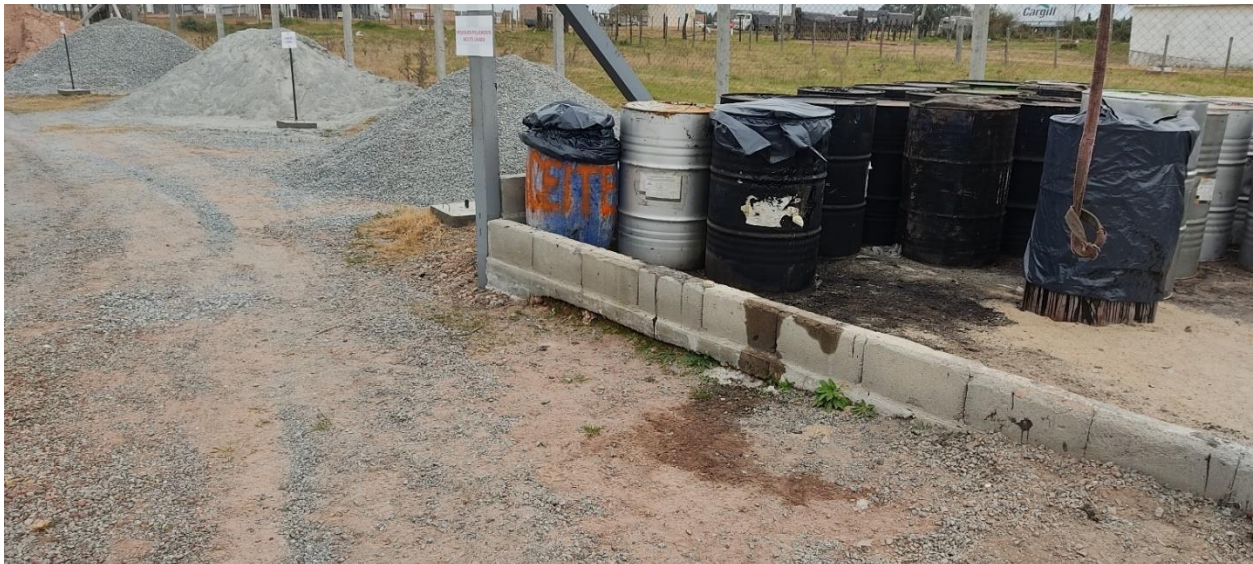
Foto 13.2-1 Derrame y dique de contención roto.
