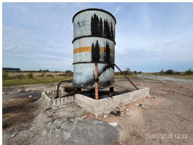
Foto 12.1-8, P03. Tanque de acopio de emulsión asfáltica, su envallado no cubre el 110% del volumen almacenado.
