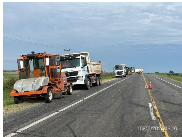
Foto 12.2-4, P04. El frente de obra no cuenta con servicios de bienestar móviles para operarios ni infraestructura para acopio de residuos segregados.
