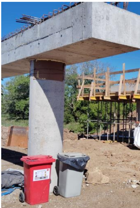
Foto 12.4-3, P02. Se reforzó la infraestructura para el acopio temporal de residuos en la zona de trabajo de la planicie de inundación
