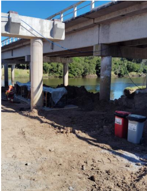
Foto 12.4-1, P01. Se reforzó la infraestructura para el acopio temporal de residuos en la zona de trabajo del dintel prefabricado
