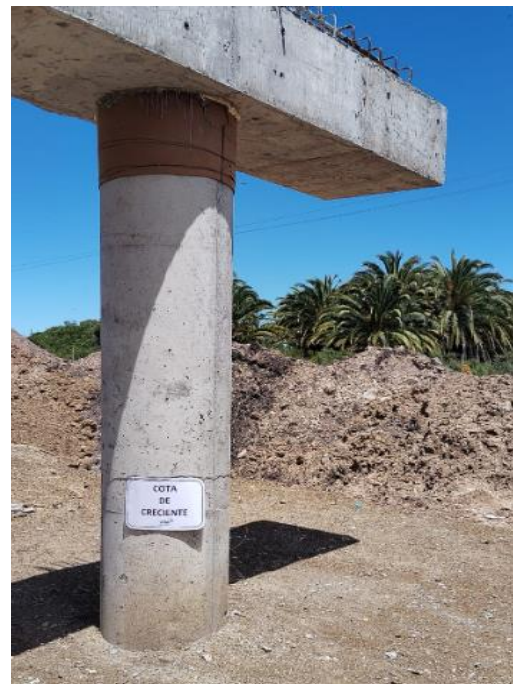
Foto 12.4-4, P02 Se demarcó la zona de máxima inundación.
