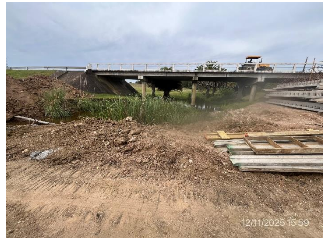
Foto 12.2-4, P02. No está demarcada la cota de la zona inundable.
