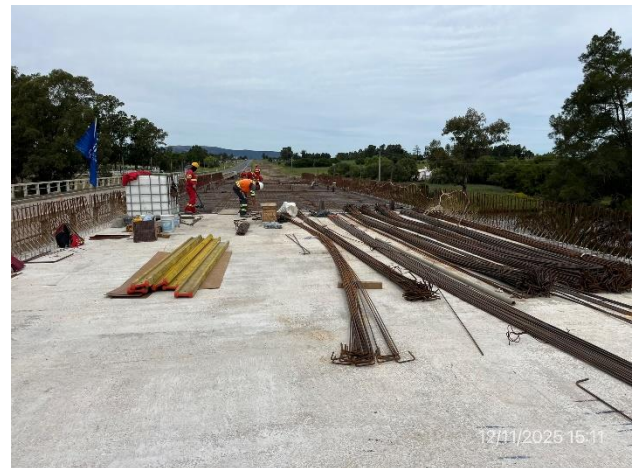
Foto 12.1-10, P01. Sector del puente con tablero en ejecución. Falta la infraestructura para el acopio temporal de residuos segregados en origen.
