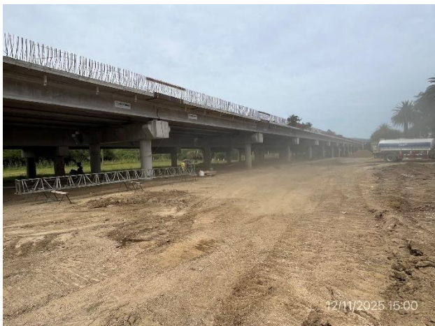
Foto 12.1-1, P01. Puente en obra sobre A° Solís G de . Ruta 9 progresiva 81K400
