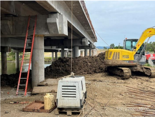
Foto 12.1-7, P01. Bidón de combustible correctamente apoyado en bandeja impermeable.
