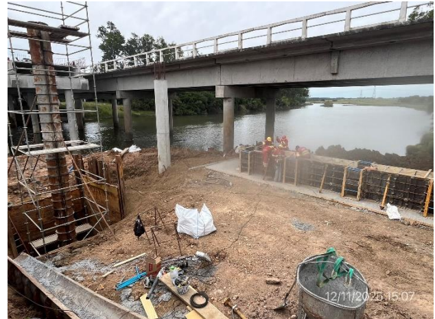
Foto 12.1-8, P01. Dintel prefabricado en ejecución. Hay residuos dispersos en la zona por falta de infraestructura para el acopio temporal de residuos segregados en origen.
