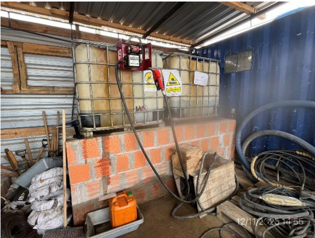
Foto 12.3-3, P03. Recinto envallado y techado para surtidor de combustible.
