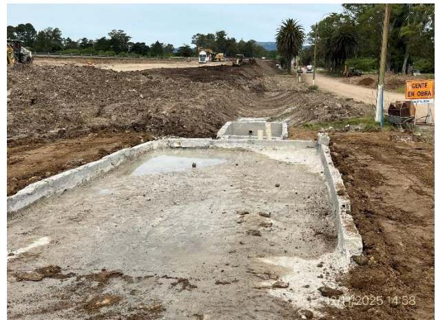
Foto 12.3-6, P03. Pileta de decantación y neutralización de aguas de lavado con hormigón.
