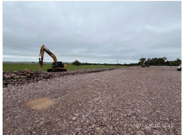
Foto 12.2-4, P08, Ruta 14 progresiva 271K500. Frente de obras vial, perfilado de cuneta en ejecución.
