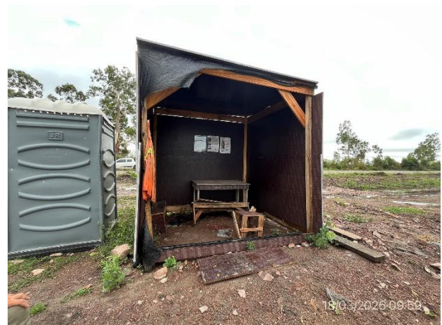
Foto 12.2-12, A29. Ruta 14 progresiva 269K600. Servicios de bienestar incompletos y falta la infraestructura para acopio temporal de residuos segregados en el origen.
