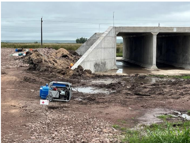
Foto 12.2-9, A30. Ruta 14 progresiva 270K450, alcantarilla terminada. Motobomba apoyada en suelo desnudo de zona inundable, sin bandeja de contención.
