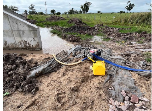
Foto 12.2-8, A25. Ruta 14 progresiva 268K900. Motobomba y bidón de combustible apoyados en suelo desnudo de zona inundable, sin bandejas de contención.
