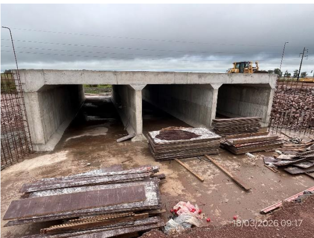
Foto 12.2-5, A01. Ruta 14 progresiva 264K950, alcantarilla en ejecución. Hay residuos dispersos, sin infraestructura para su acopio segregado desde el origen.
