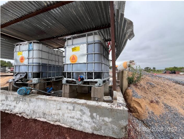
Foto 12.1-3, P03. Planta de hormigón, aditivos químicos en local techado y con envallado perimetral.
