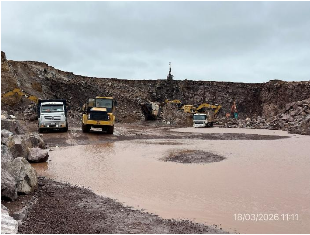
Foto 12.1-19, P06. Cantera de piedra, padrón Rural N° 15951 de la 10ª S.C. de Lavalleja.
