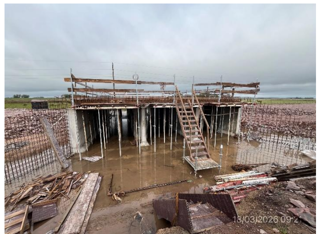
Foto 12.2-6, A03. Ruta 14 progresiva 265K150, alcantarilla en ejecución. Hay residuos bajo el agua, sin infraestructura para su acopio segregado desde el origen.
