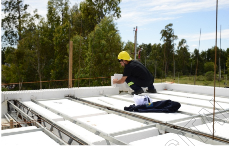
Figura 7a: Imágenes de ejecución de entresijos, se pueden visualizar las juntas entre paredes y entresijo antes del hormigonado.
