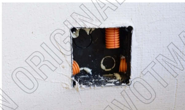
Figura 23: Imagen de caja de registro instalada dentro de la capa de espuma. La pared tiene aplicada una capa de malla de fibra de vidrio y Base Coat Fino RST.
