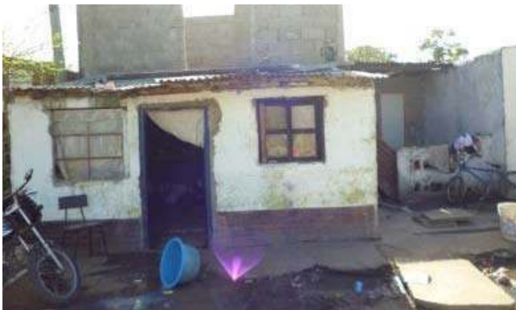
Figura 16. Vivienda en estado de precariedad.
