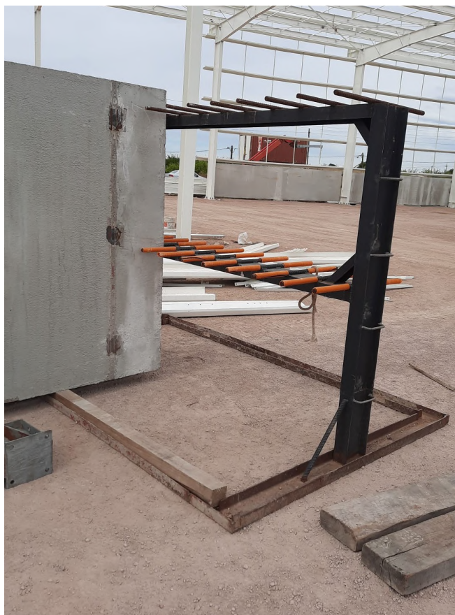
Ref: 6 / Atriles metálicos para traslado de las placas.
