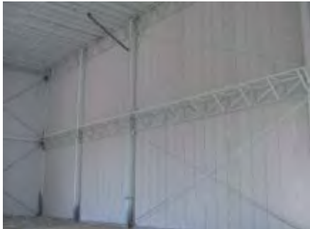
Fig. 22: Vista interior de panel en arreglo vertical.
