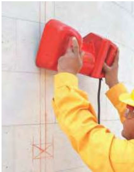
Fig. 16: Ranurador eléctrico Macroza.
