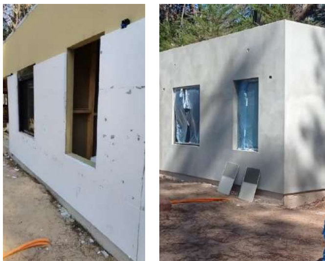
Foto izquierda: Colocación de EPS en muro exterior sobre membrana líquida STO Gold Coat.
