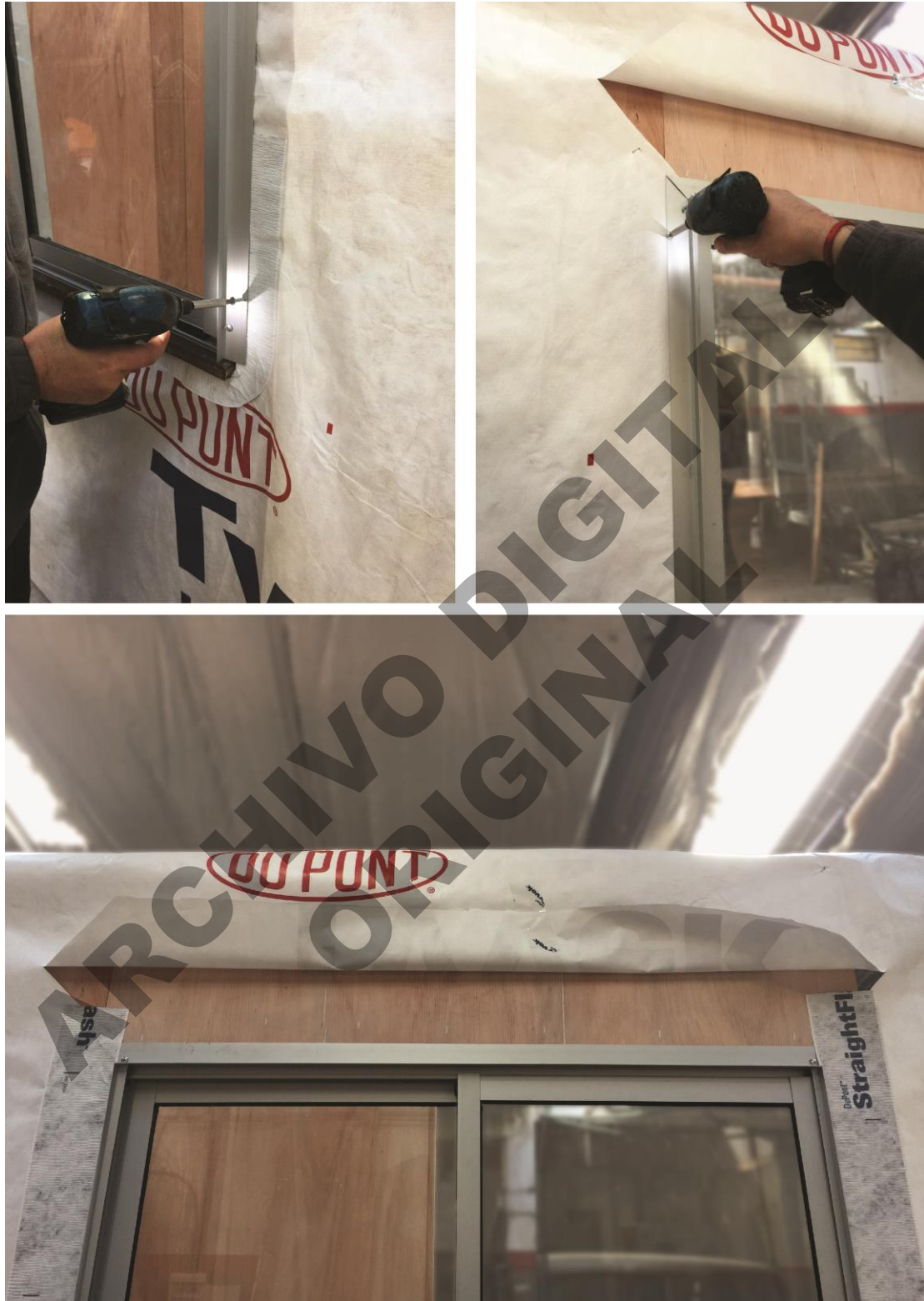
Posicionado y fijación con tornillo flangeados 4.2x25mm: nivelación, aplomado y escuadra. Colocación de cintas autoadhesivas StraightFlash sobre aletas laterales.
