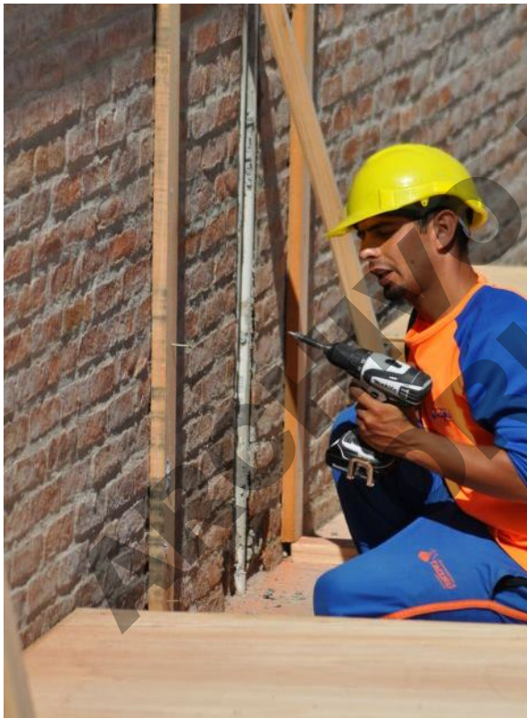
Colocación de solera sobre pared de ladrillos, previa colocación de banda acústica 70mm.
