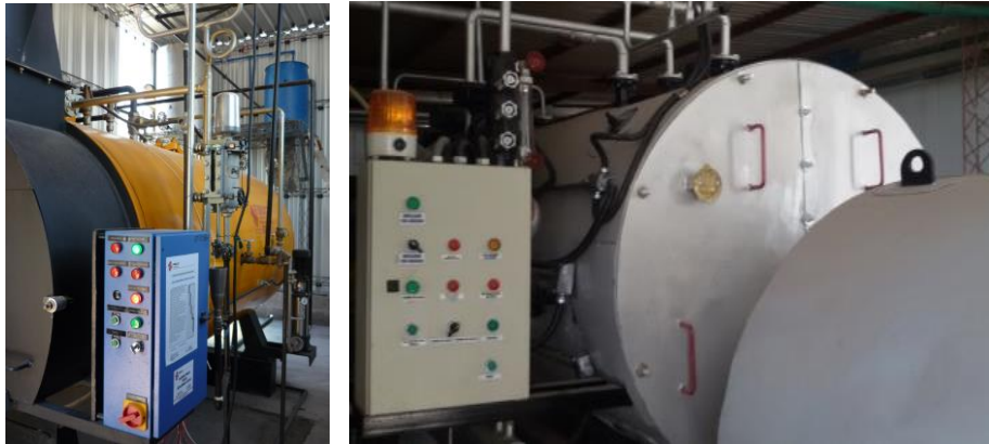
Generador de Vapor Nuevo (izquierda) y Usado (derecha) instalado en queserías.
